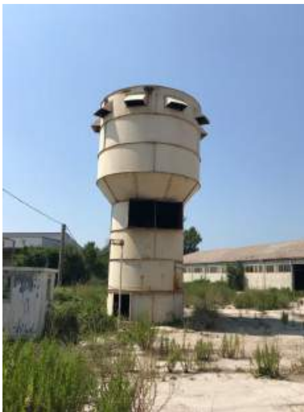
Figura 29: Filtro a torre metallica
