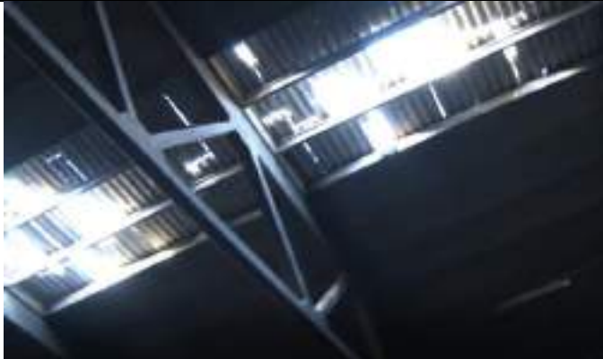
Figura 19: Particolare di copertura ad onduline in cemento amianto danneggiata (interno Capannone Reparto ricevimento, alimentazione, cernita)
