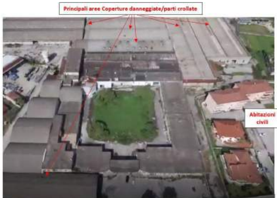
Figura 9: Ubicazione coperture danneggiate (esterno Capannone Reparto ricevimento, alimentazione, cernita, ripreso da volo con drone) e indicazione delle abitazioni civili in prossimità del sito
