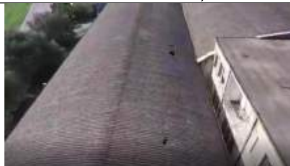
Figura 22: Particolare di copertura ad onduline in cemento amianto danneggiata (esterno Capannone Deposito tabacco 5, ripreso da volo con drone)
