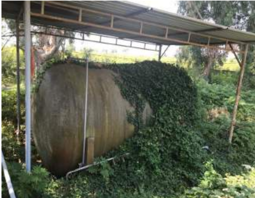
Figura 28: Serbatoio accumulo acqua antincendio
