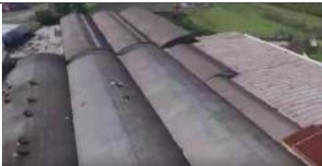
Figura 21: Particolare di copertura ad onduline in cemento amianto danneggiata (esterno Capannone Deposito tabacco 3, ripreso da volo con drone)
