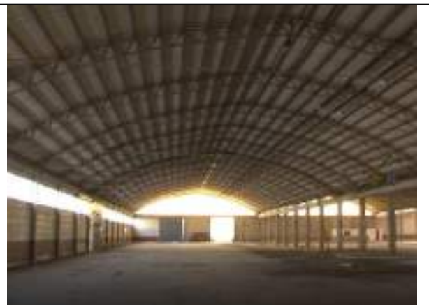
Figura 14: Copertura a volta con presenza di onduline in cemento amianto e pavimentazione industriale
