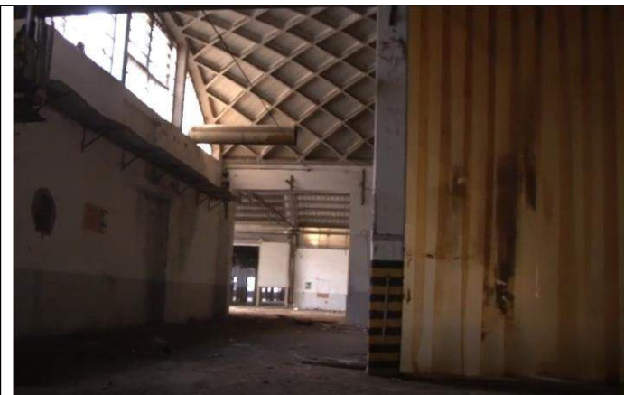
Figura 13: Copertura a volta con presenza di lastre piane in cemento amianto e pavimentazione industriale
