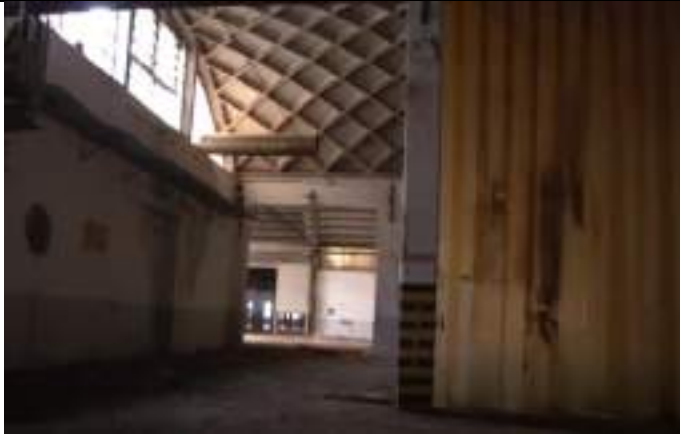
Figura 17: Copertura a volta con presenza di lastre piane in cemento amianto e pavimentazione industriale
