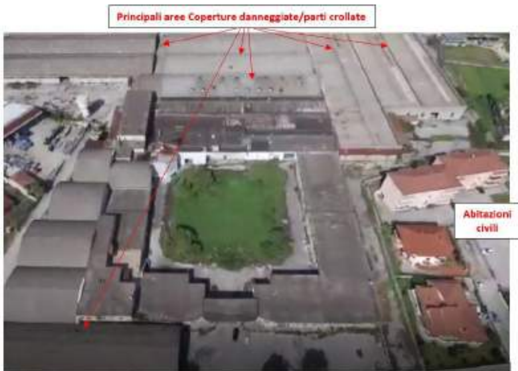
Figura 23: Ubicazione coperture danneggiate (esterno Capannone Reparto ricevimento, alimentazione, cernita, ripreso da volo con drone) e indicazione delle abitazioni civili in prossimità del sito
