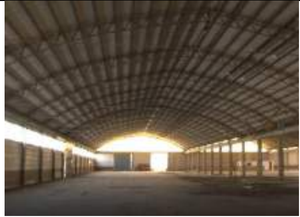
Figura 18: Copertura a volta con presenza di onduline in cemento amianto e pavimentazione industriale
